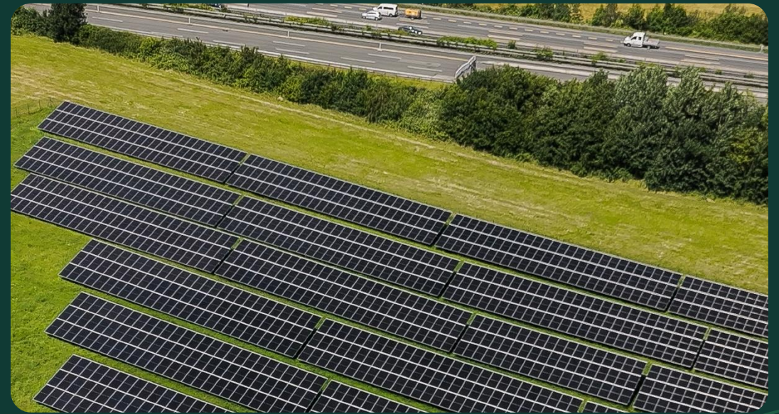
Solarpark an der A448 in Witten-Annen
